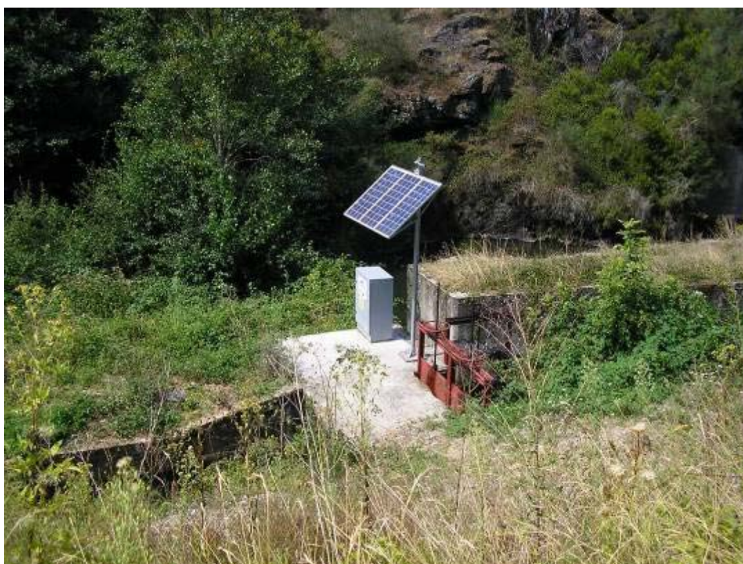
Figura 11: Estación de zona regable R004 en la toma del canal alto del valle de Lemos
