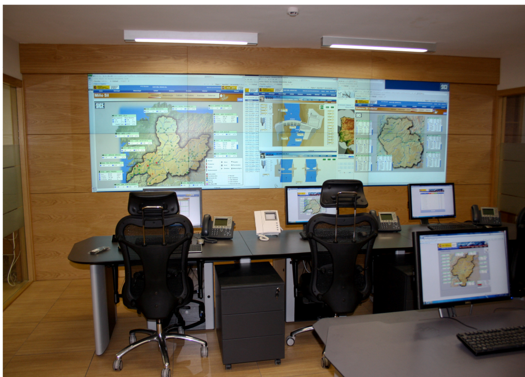
Centro de Control de Cuenca
